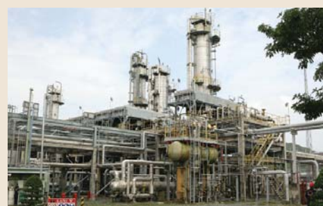
Nhà máy xử lý khí Dinh Cố. Ảnh: PV GAS
